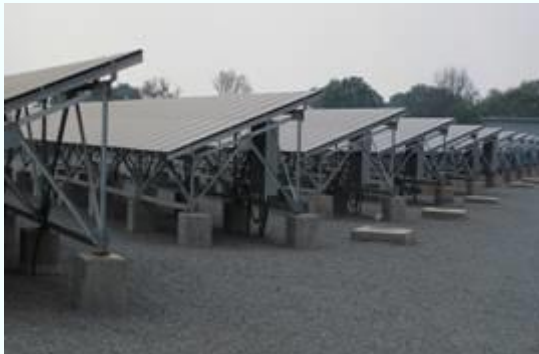
設置されたソーラーパネル
